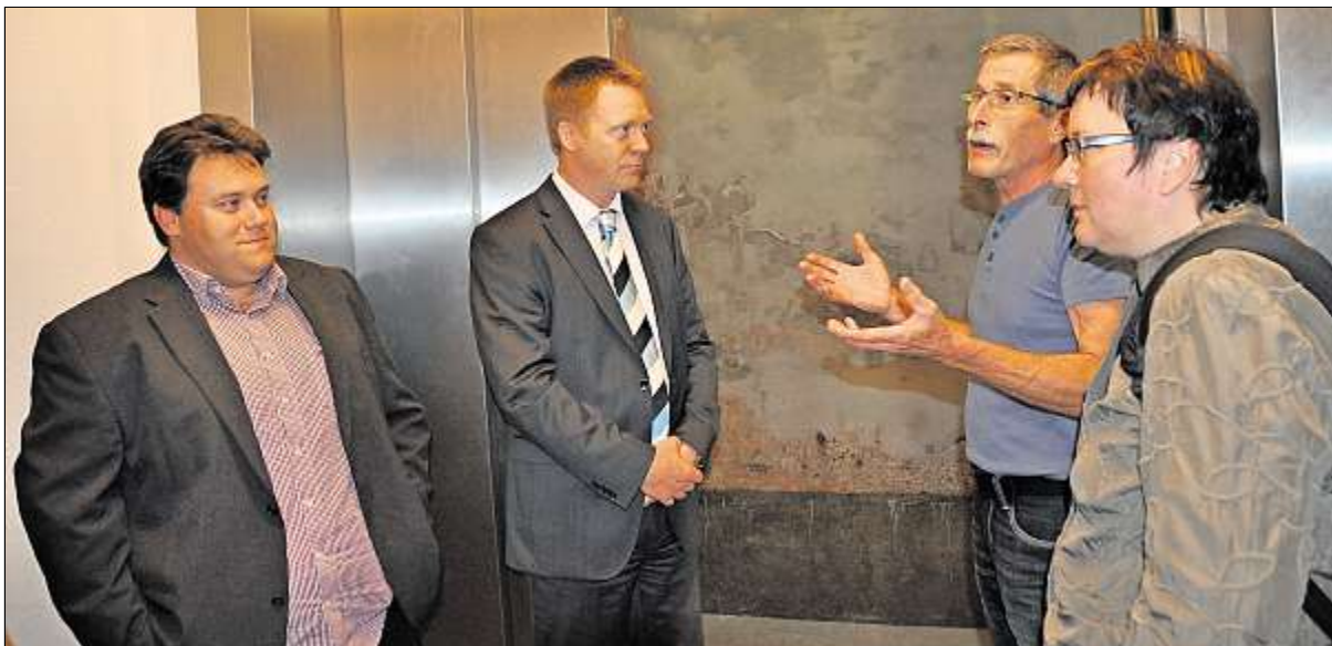
Im Fahrstuhl-Schacht des Theaters stand Ende Mai/Anfang Juni das Grundwasser – und nicht nur dort. Haus-Inspektor Kurt Brachmann (2. v. r.) informierte Bürgermeister Fabian Giesder, Minister Christoph Matschie und der Bundestagsabgeordnete Iris Gleicke über die Schäden und geplanten Schutzmaßnahmen. Foto: M. Hildebrand-Schönherr
